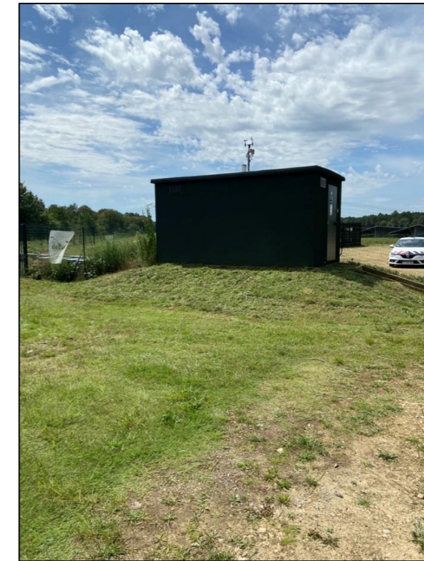
Figure 10 : Illustration d'un poste de livraison (Source : NEOEN)
