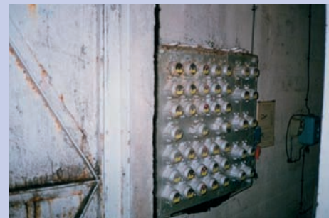
Extensomètres sur le barrage de Lardit (Lot). Ces appareils servent à mesurer les déformations du barrage.
