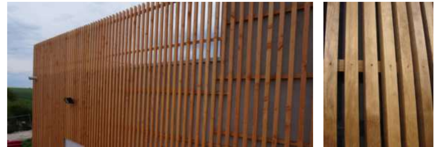
Photographie 179 : Exemple de bardage bois à claire-voie vertical garantissant l'intégration paysagère du poste de livraison tout en évitant l'installation des chiroptères attirés par le confinement.
