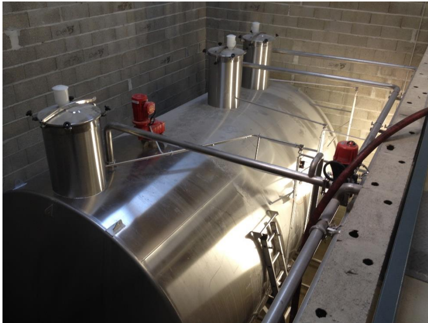
Figure 9 : Cuve de récupération des brouillis
