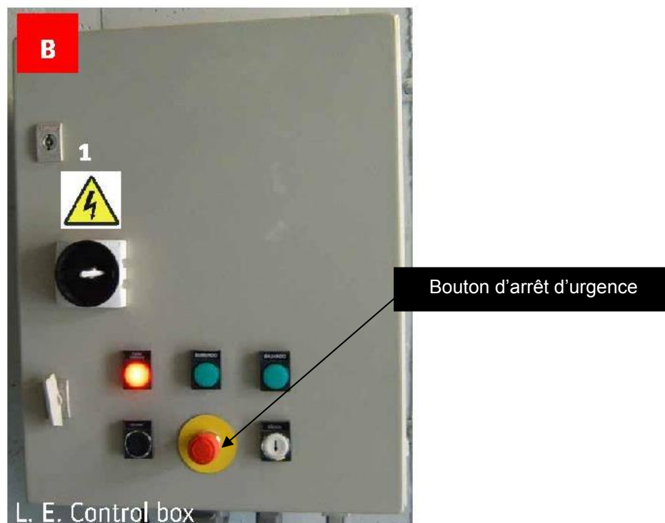
Figure 8 : Bouton d'arrêt d'urgence sur la boîte de contrôle de la nacelle
