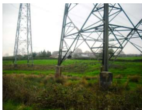
Pylônes sur le terrain
