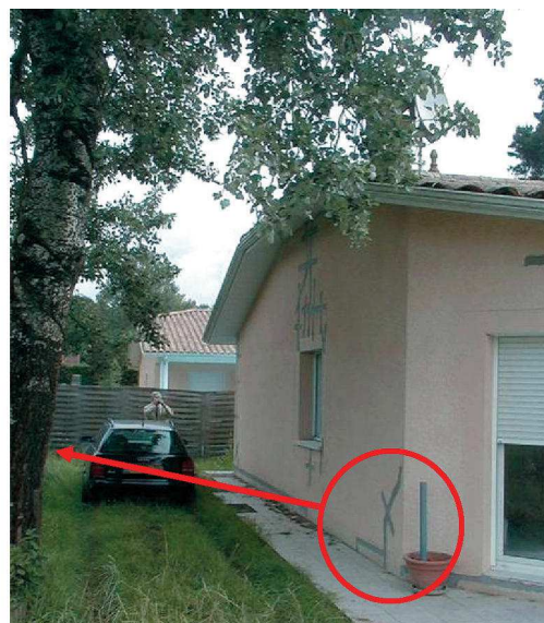
Figure 15 Fissures traitées provoquées par la présence d'un arbre (Source Socabat)
