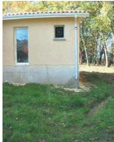
Figure 11 La descente d'eaux pluviales non raccordée concentre l'hydratation accidentelle dans l'angle. Les eaux ne sont pas évacuées du fait de l'absence d'un nivellement adapté et stagnent non loin de l'angle (Source Socabat)
