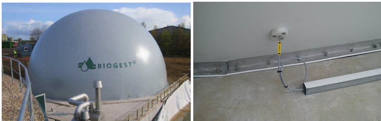
Figure 18 : Photo du gazomètre retenu et système de fixation au sol (Source : Biogest)
