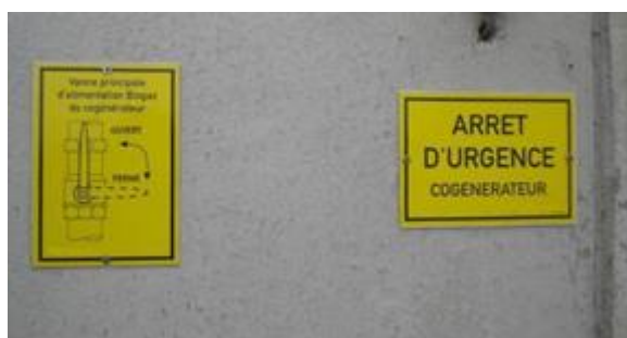
Figure 62 : Exemple de dispositif coup de poing à l'extérieur d'un local de cogénération (Crédit photo : NCA, 2011)
