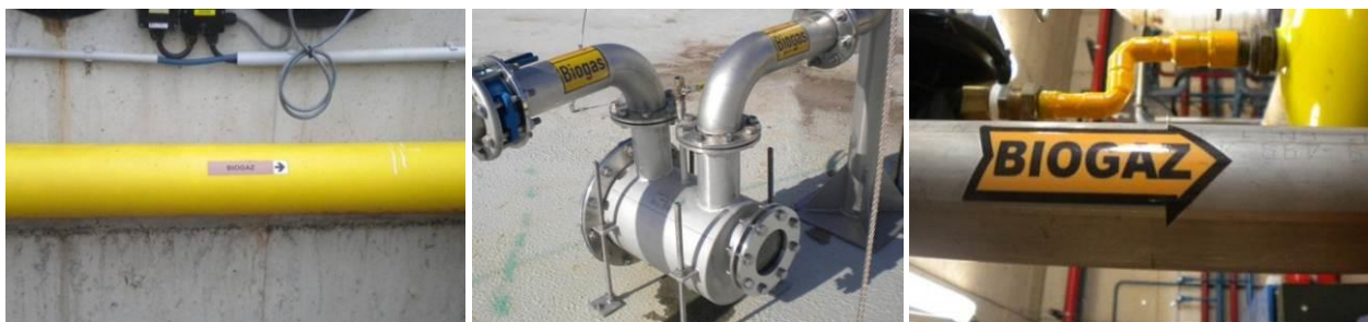
Figure 35 : Exemples de repérage des canalisations de biogaz (NCA, 2011)
