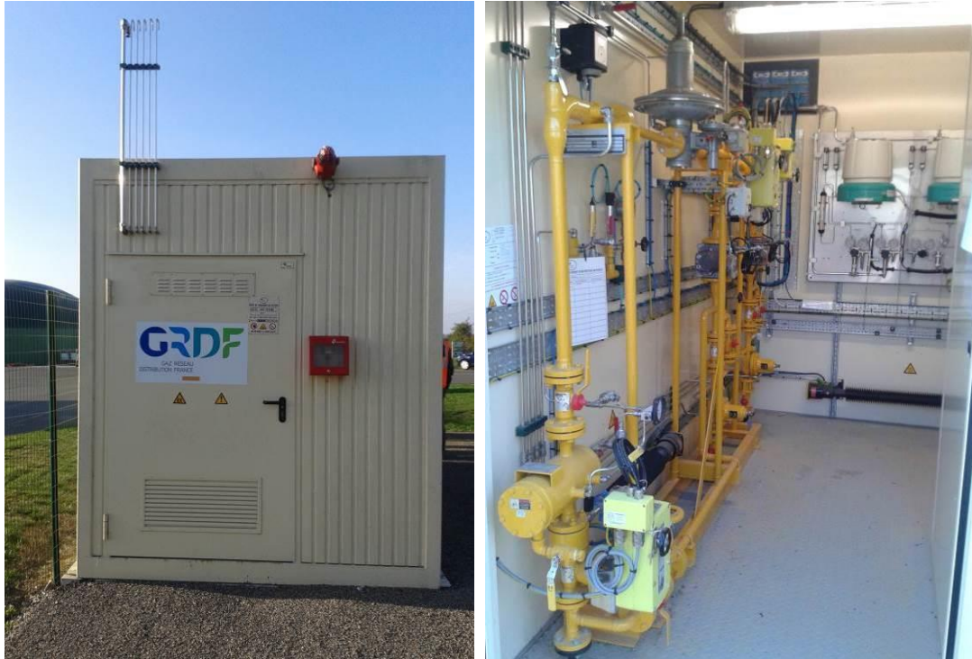
Figure 29 : Vues intérieure et extérieure (arrière) d'un poste d'injection GrDF (Crédit photo : NCA, 2016)
