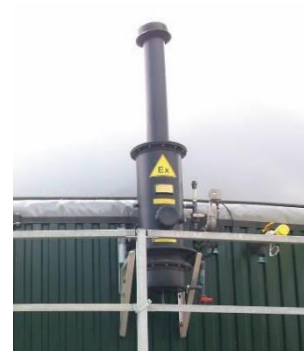
Figure 20 : Exemple de soupape de sécurité sur un digesteur (NCA, 2012)
