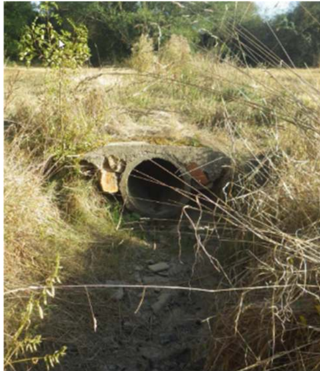
Figure 1 : Bassin versant n°1 (OH11) – Vue en amont du franchissement par la RN141
