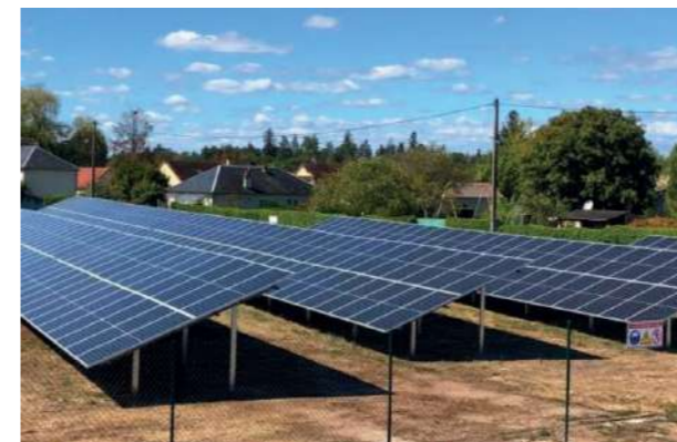
CENTRALE AU SOL SALBRIS
