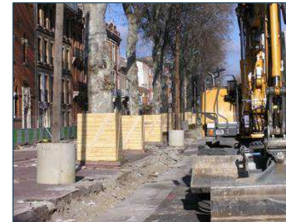
Système de protection des arbres par des planches
