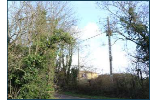
Ligne électrique au Sud du site
